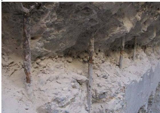
Image 1 : Corrosion de l'armature
