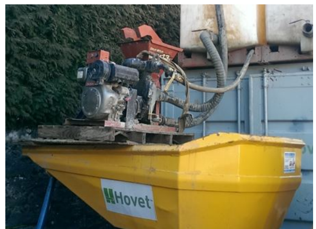
Serbatoio per le iniezioni di Bentonite
